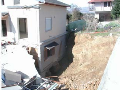
Κατολίσθηση στο Χαροκόπι Ιωαννίνων 12/2005
